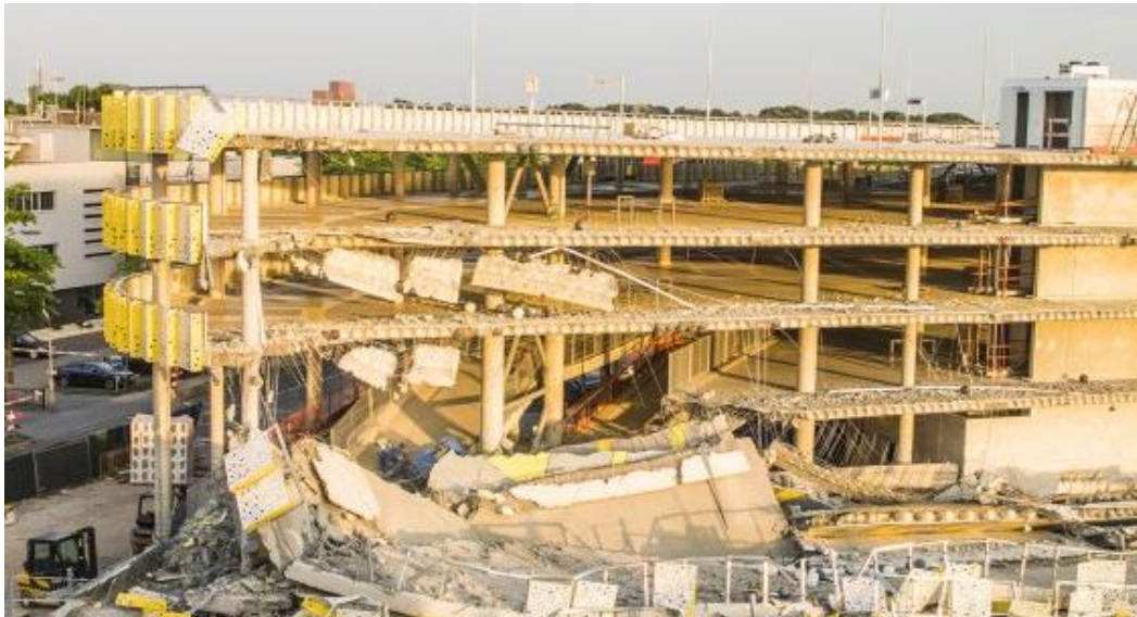
Ingestorte parkeergarage Eindhoven Airport - Sem van Rijsel
